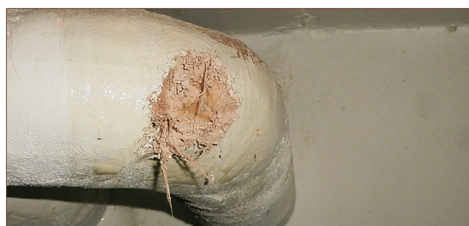
Masa azbestowa w izolacji kolana rury. Najczęściej stosowana w okresie 1955 - 1978. UWAGA: Pylisty brązowy azbest jest bardzo szkodliwy dla zdrowia.
