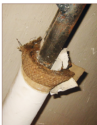
Biała tektura azbestowa wewnątrz rury (pod brązową tkaninę jutową). Najczęściej stosowana w okresie od 1900 do 1960.
