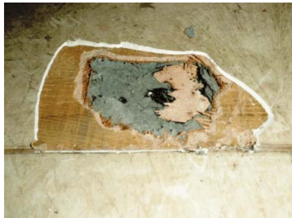
Figur 22 Her er det eldste linoleumsbelegget limt til ullpapp, og ullpappen er limt med svart lim til betongen. I senere tid er det lagt et lag vinylbelegg på toppen (foto: Geir Sandberg).
