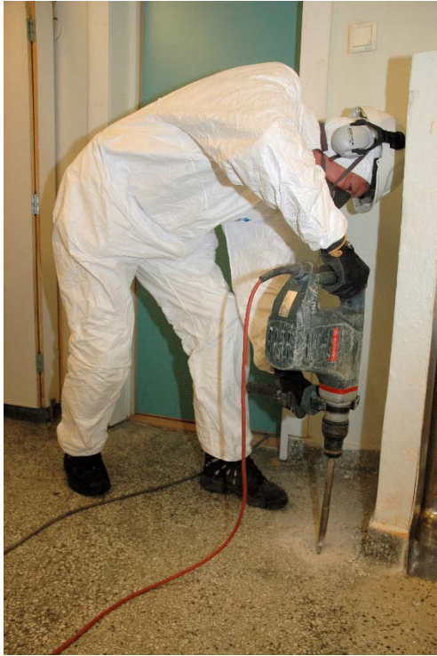
Figur 2 Bruk av elektrisk borhammer for prøvetaking av betong (terrazzo, i dette tilfellet) (foto: Geir Sandberg).
