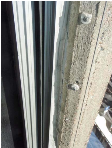
Figur 23 Mye av opprinnelig PCB-holdig fugemasse er fjernet med kniv, men det sitter fortsatt en del igjen som må saneres. Den nye fugemassen inneholdt klorparafiner, og måtte også saneres (foto: Eirik Wærner).
