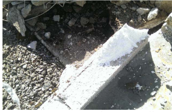
Figur 27 Isopor som sitter fast i betong (foto: Norsk Saneringsservice).
