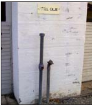
Mange bilverksteder har en nedgravid spilloljetank (som kan være/ha vært lekk)
