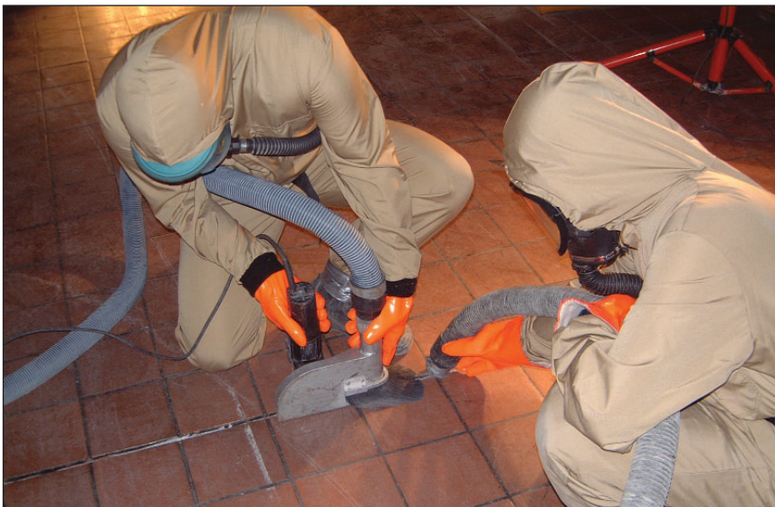
Sanering av PCB-holdig fugemasse i gulv. (Foto: Arne Hugo Elde, Rivningsspesialisten AS)
